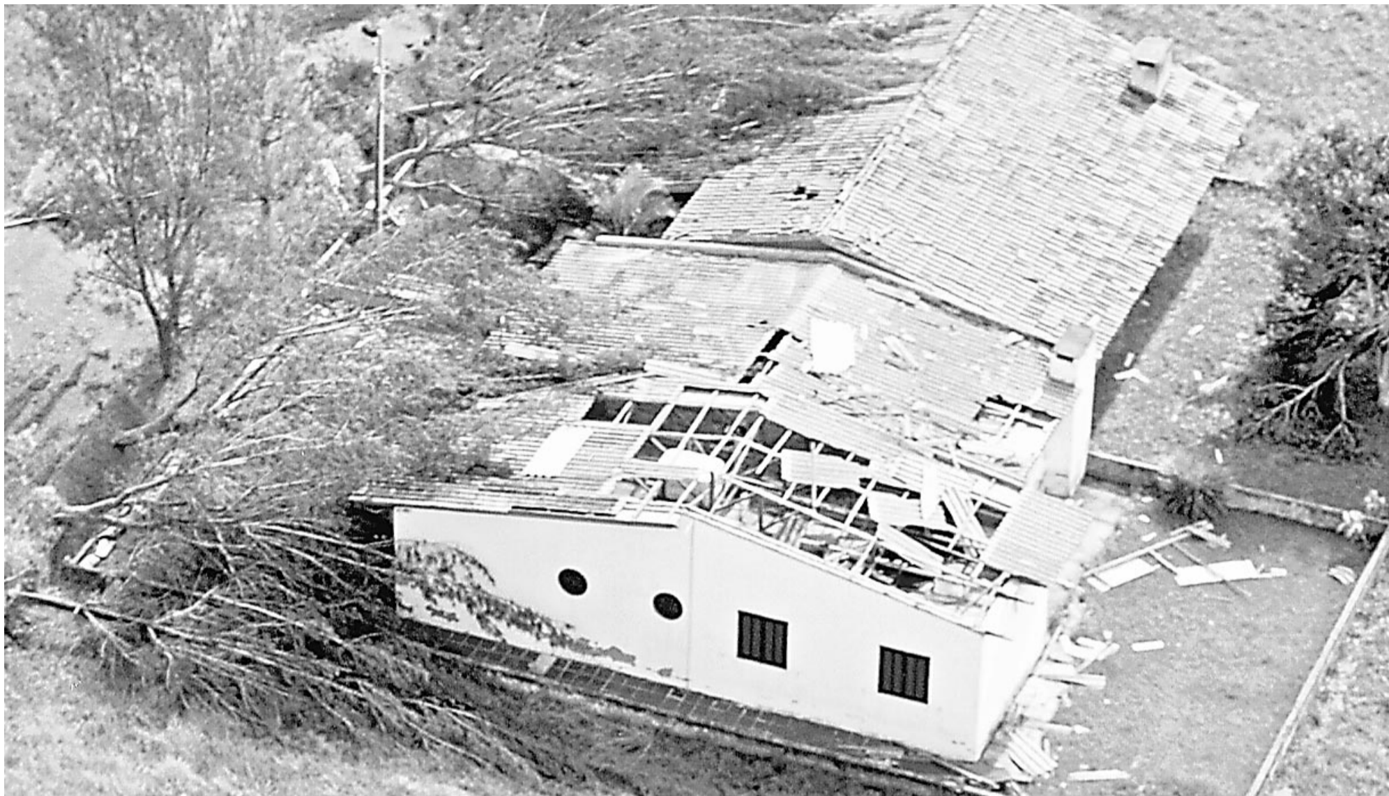
FÚRIA: Ventos de até 150 quilômetros por hora tombaram árvores e destelharam propriedades como esta em Passo de Torres, um dos municípios mais atingidos no Sul do Estado
